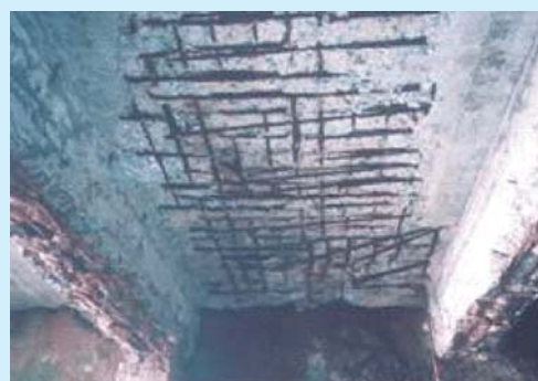
写真1 栈橋上部工の劣化事例（床版）
