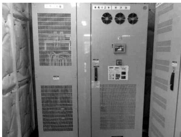
写真－11. 蓄電池設備 電源盤
