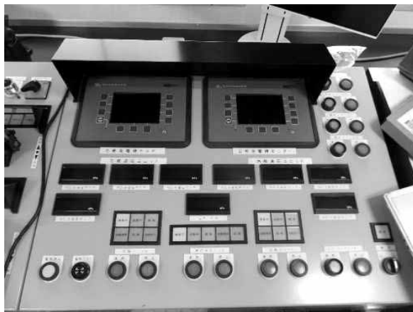
写真－５．主発電機遠隔監視システム
