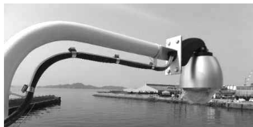
写真－13. 甲板用監視カメラ×8台
