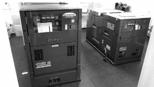
写真-4 発電装置（補・停泊用発電機）
