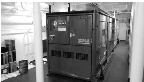
写真-3 発電装置（主発電機）
