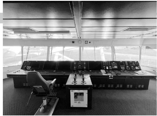
写真 ブリッジの操作盤
