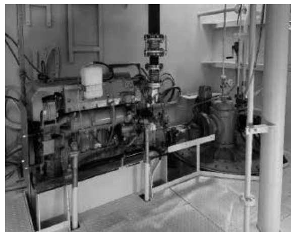
写真-9 スラスターエンジン (Nox値 7.7g/kWh<14.4g/kWh)
