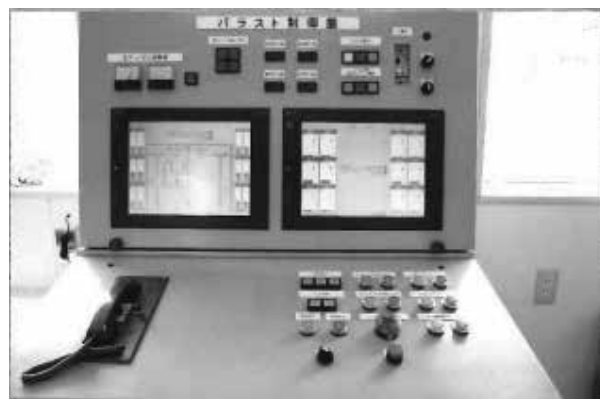
写真-3 バラスト制御盤
